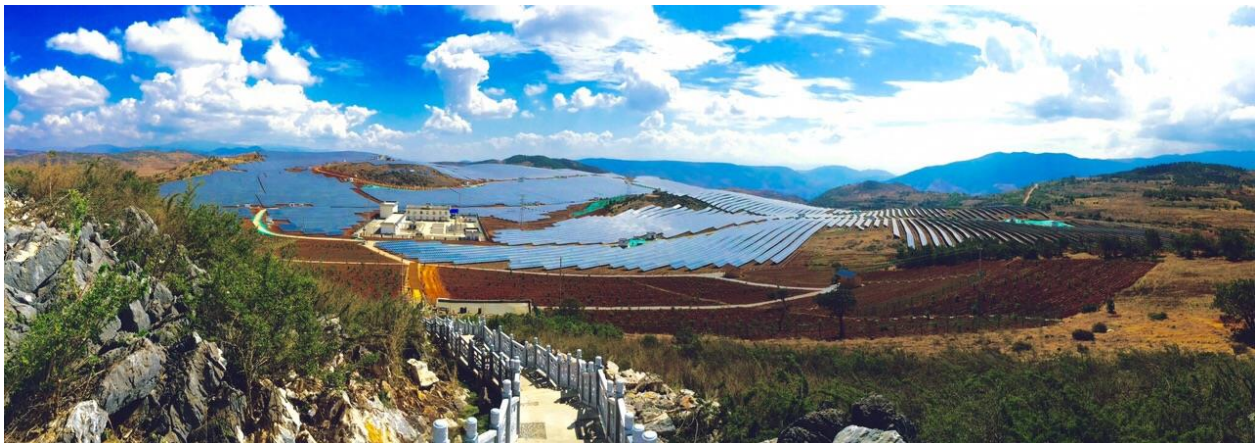
西村一期光伏电站发电容量为 50 兆瓦直流容量，占地 86 公顷，共安装了 204,600 块太阳能光伏板。（按 此 观看项目影片）
