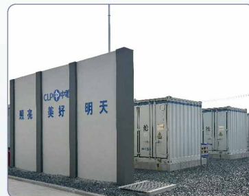
江苏宜兴一期电池储能系统
